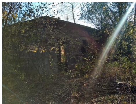
Fot. 20. Zaniechana niewielka część działki – ruina obiektu oraz nieuporządkowana zieleni (samosiejki)
